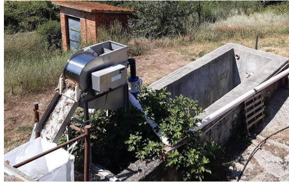
Figura 6 – Vasche di pretrattamento in disuso
